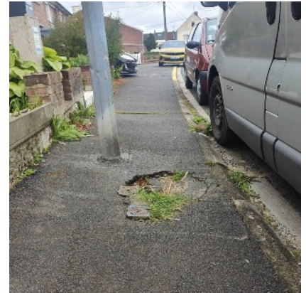
Photo 6 : trou dans la chaussée rue Victor Delannoy
